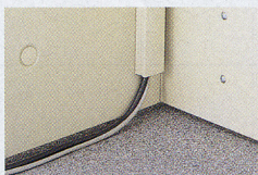
縦配線ダクト
